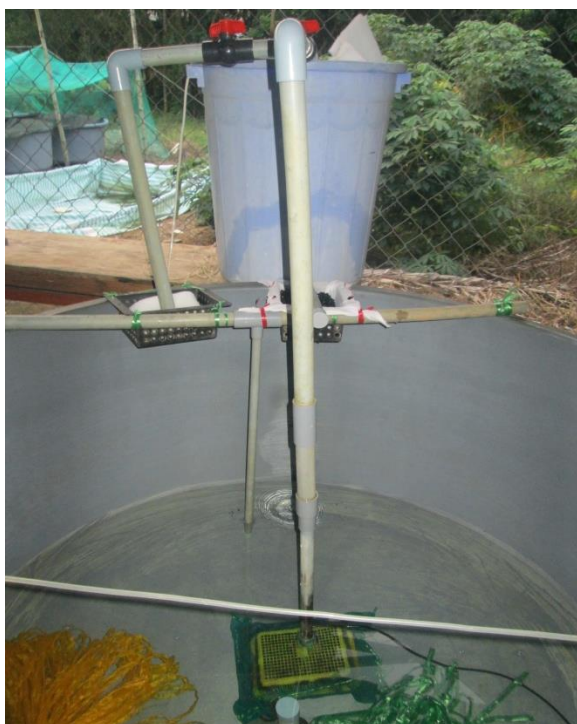
Hình 2: Hệ thống lọc
